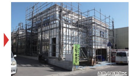
遮熱外断熱施工 ▲遮熱面材を貼った外断熱材を全面に施工した状態である。断熱材の取り合い部分は、気密テープでシールされている。この上に通気胴縁を施工し、サイディングやモルタルなどの外壁が施工される。
