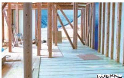
床の断熱施工 ▲床の断熱施工は、基礎・土台の施工が完了したと同時に終わられ、断熱受材には気密テープが貼られて断熱を完了させ、プラットホームにした後に構造材が構築される。屋根・天井・壁面の断熱施工が完了し、開口部が施工された後に、床に気密シートが張られ、構造用合板が敷かれて断熱と床の下地工事が完了する。
