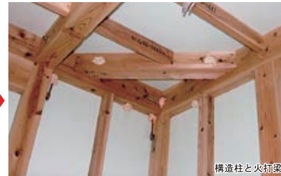
構造柱と火打梁 ▲梁・柱、火打梁の施工例である。木構造と耐震金物との組み合わせで強度を保っている。外部と連結する耐震金物は、熱橋となって結露を発生させる危険性があるため、全て発泡ウレタン断熱材で断熱補強されている。
