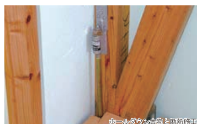
ホールダウン金物と断熱施工 ▲コーナー柱のホールダウン金物の最終的な施工状況である。アンカーボルトは見えなくなっている。新たに防交いが施工されて壁には断熱材が施工される。柱が細く見えるのは、柱の一部を欠き込んで断熱材を施工しているからである。これで完成ではなく、金物と壁断熱材と床下地合板の間に防蟻ウレタンが施工される。
