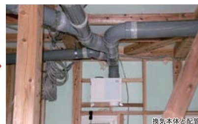
換気本体と配管 ▲換気装置はスウェーデン製の第三種換気を採用している。上部に見える配管で汚れた空気を排気し、給気は給気口で行うというシンプルな構造であるが、その確実性から世界で最も採用例の多い換気装置である。
