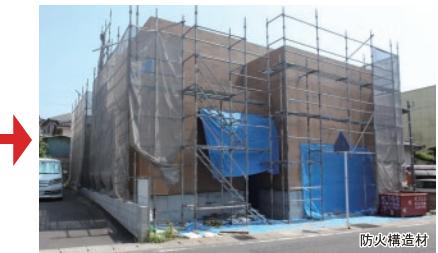
防火構造材 ▲防火構造材（火山性ガラス質構造用面材）でスッポリと覆われた状態である。この構造用面材は通気性が有り、防火性に優れた燃えない建材である。通常の施工では、この上に通気層が設けられ、サイディングが施工される。
